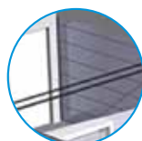
Трубопроводи для холодоагенту (і BS-блок*)
